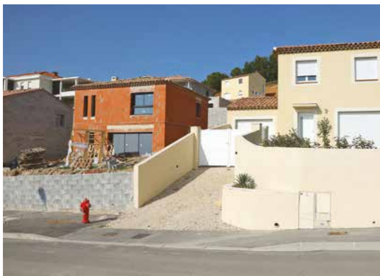
Dans ce quartier en construction, les maisons ont toutes été équipées de compteurs Linky.
